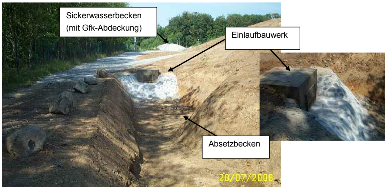
Abbildung 6 Absetzbecken mit Einlaufbauwerk
